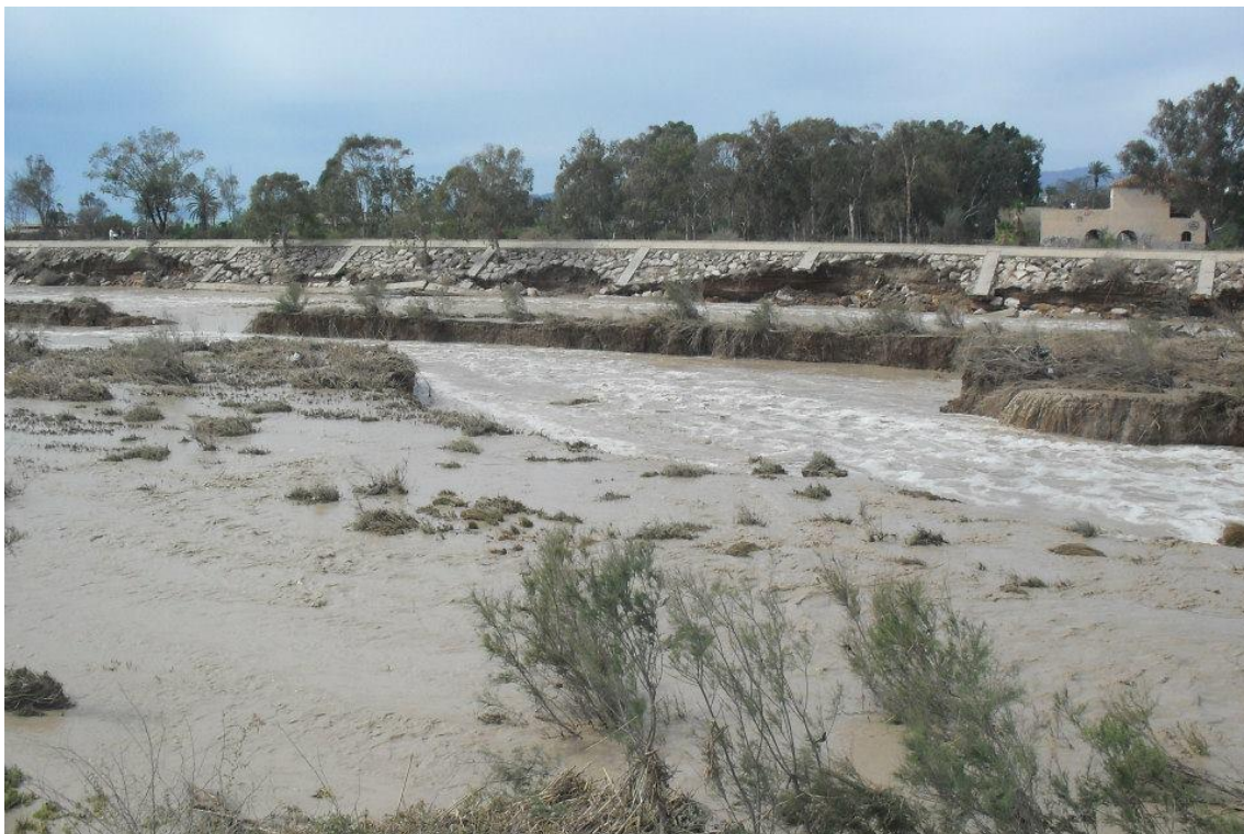
Figura 2. Daños en el encauzamiento de la rambla de Las Moreras tras el episodio de lluvias torrenciales de 2012
